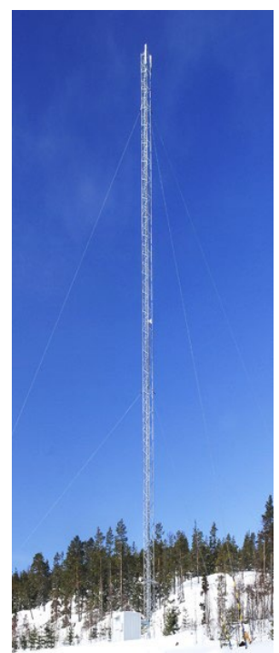
Antennbärartyp: 3-sidigt fackverksmast Stagad
